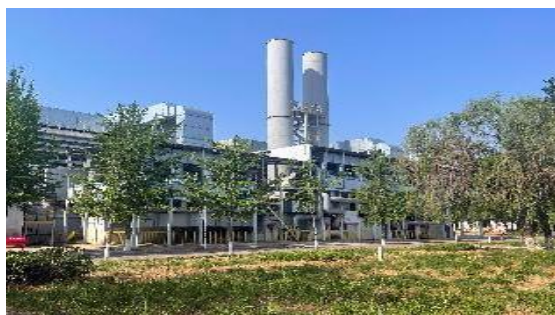
废气治理设备
