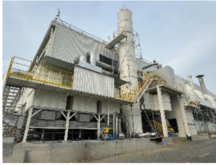
废气治理设备
