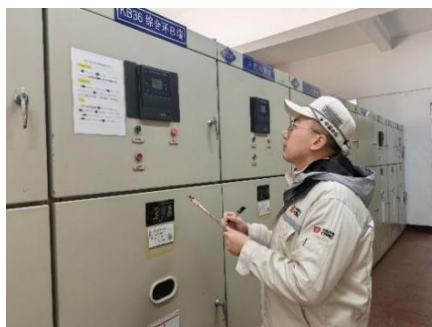
员工监测供电系统运行数据
