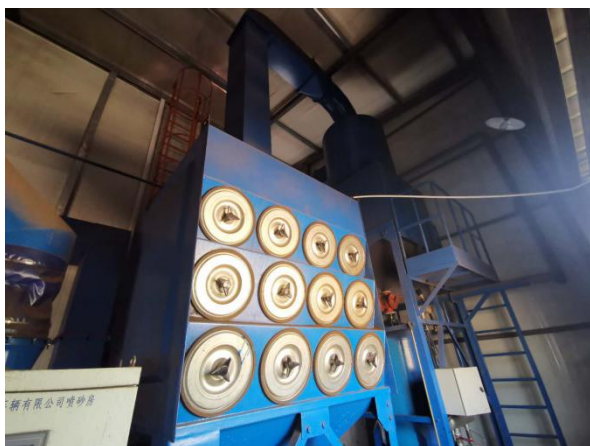
砂回收设备及滤筒除尘器
