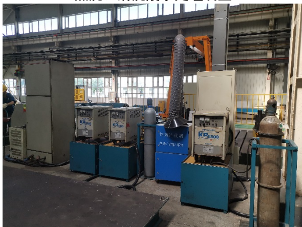
焊接烟气净化设施
