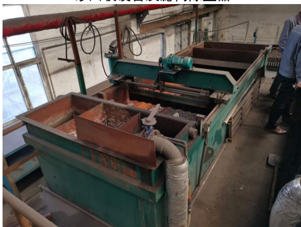
煮洗、清洗废水处理装置
